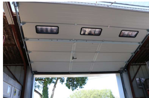
Equipements de mise aux normes et sécurisés
